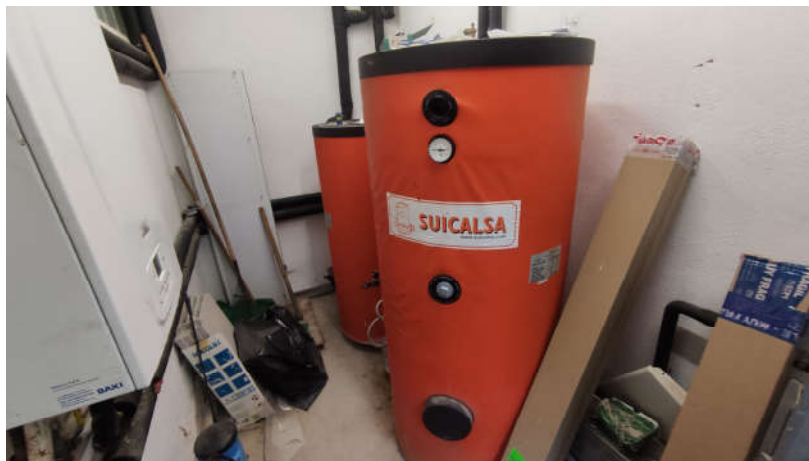
Sala de calderes dels Vestuaris del tennis/padel
