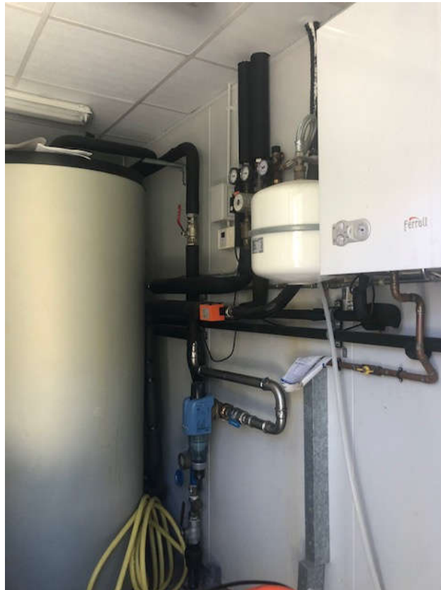
Sala de calderes del Camp de futbol
