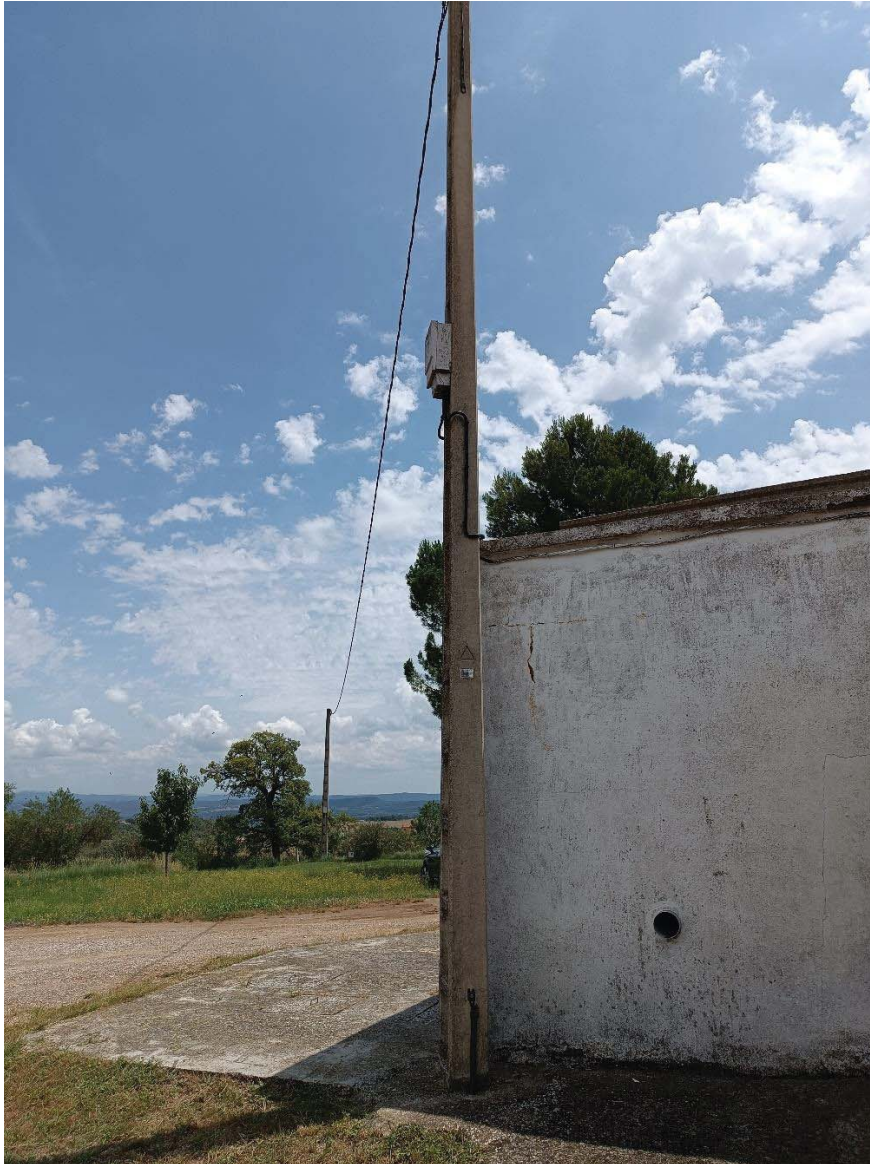
Fig. 5 Vista ubicació de l'escomesa amb CGP-7 i línia aèria del subministrament actual de l'emplaçament
