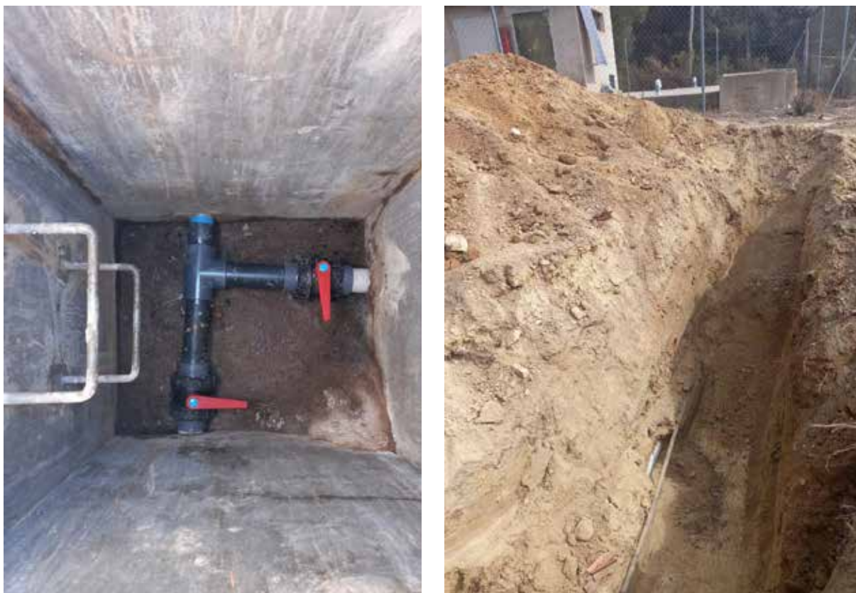
Rasa per canvi de canalització del sistema de tubs d'aigua clorada de l'Àrea d'esplai. Font: Arxiu XPN
