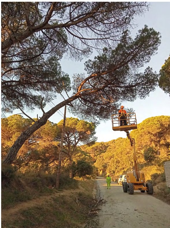
Retirada de pi tombat sobre línia elèctrica (Premià de Dalt). Font: Arxiu XPN
