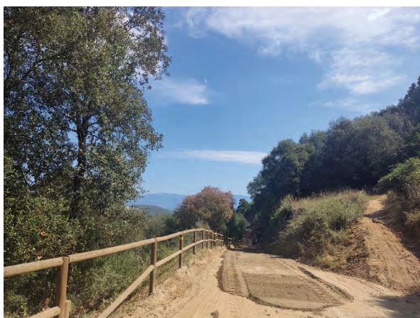
Reparacions del ferm a l'entorn de Ca l'Arcís (Vilassar del Dalt). Font: Arxiu XPN
