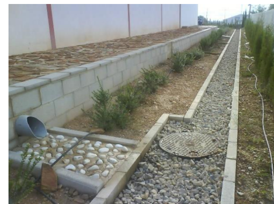
Drenes filtrantes en Crevillent (Alicante).
