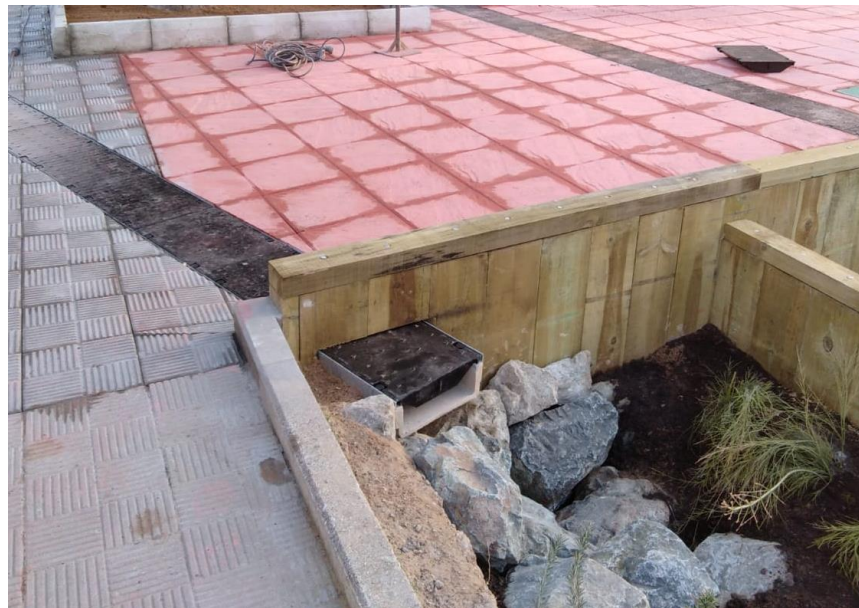
Imagen 12. Elemento de entrada a un jardín de lluvia en Sevilla. Fuente: EMASESA.
