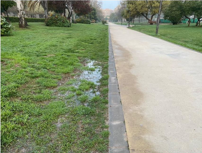
Imagen 24. Cunetas drenantes del Jardí del Túria tras un evento de lluvia.
