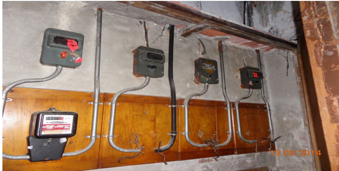
Armari elèctric fora de normativa
