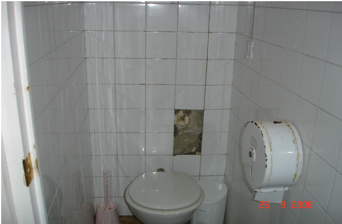
Cambra higiènica en mal estat
