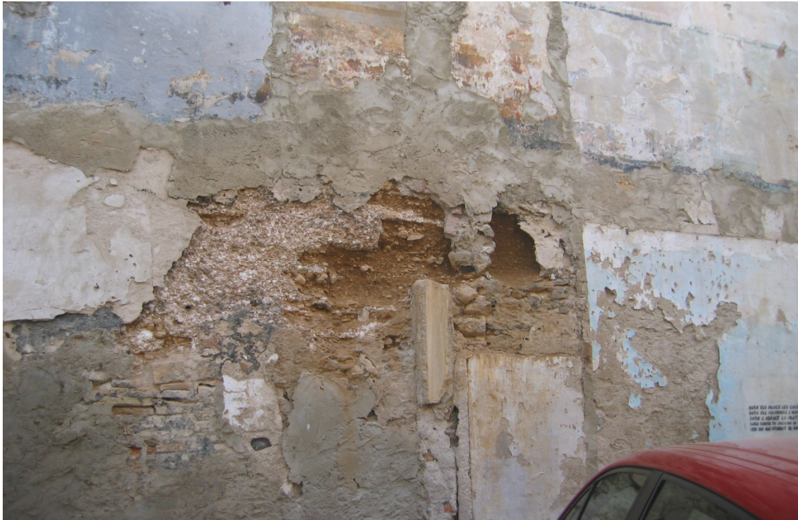
Façana de tàpia degradada
