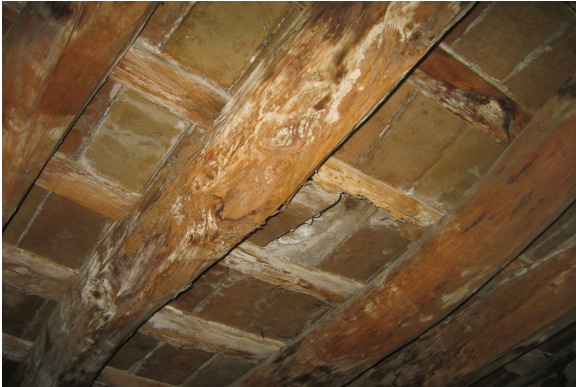
Estructura de fusta en mal estat
