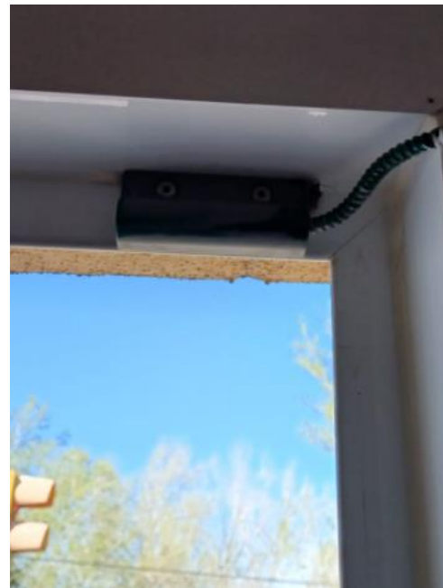
sensor d'obertura de portes a l'oficina
