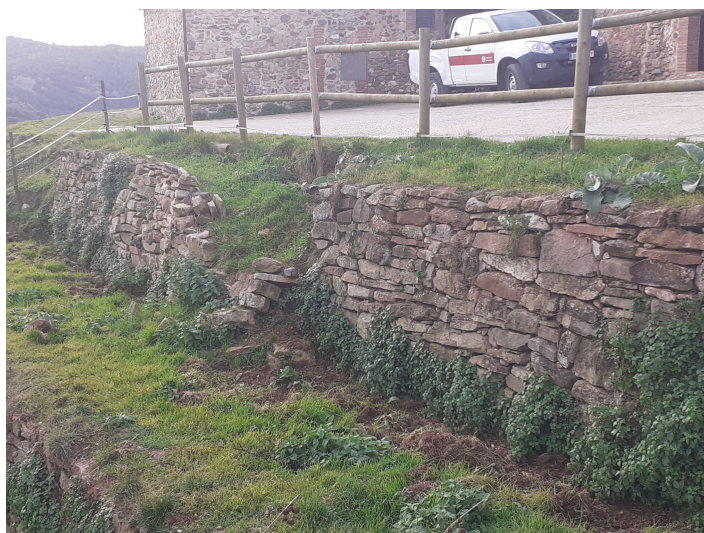
Mur de l'hort de la Mata abans de les obres de restauració. Foto: Arxiu XPN.
