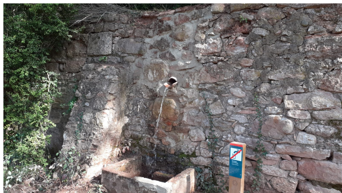
Arranjament del sobreixidor de la bassa de la casa de la Vall. Foto: Arxiu XPN
