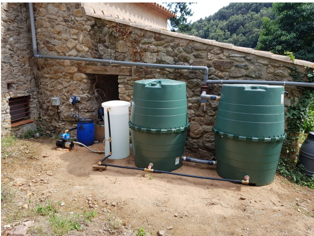
Sistema de recollida de pluvials instal·lat al parc. Foto: Paisatges Vius
