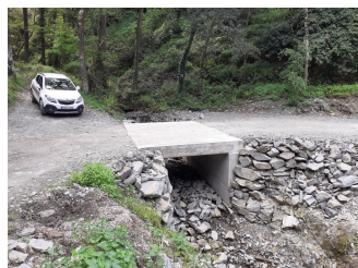
Pas d'aigua encreuament pistes de la xarxa viària del parc
