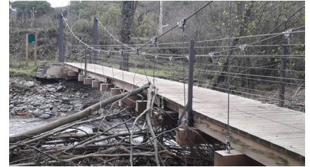
Revisió del pont penjant de l'itinerari del castell de Montclús, a Sant Esteve. Foto: Arxiu XPN
