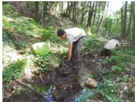
Restauració d'urgència d'una riera per facilitar el manteniment de bassetes d'aigua a l'estiu i per millorar la probabilitat de supervivència de cranc de riu. (Foto: Colla de manteniment)
