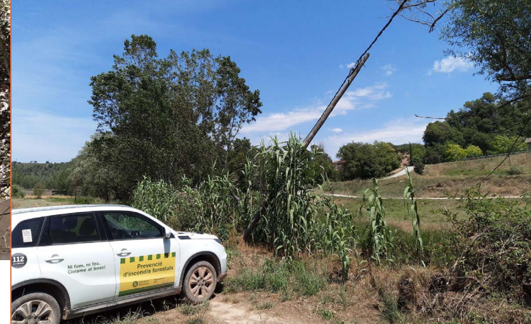
Línia elèctrica en mal estat. Autor: Marc Vilella. Diputació de Barcelona
